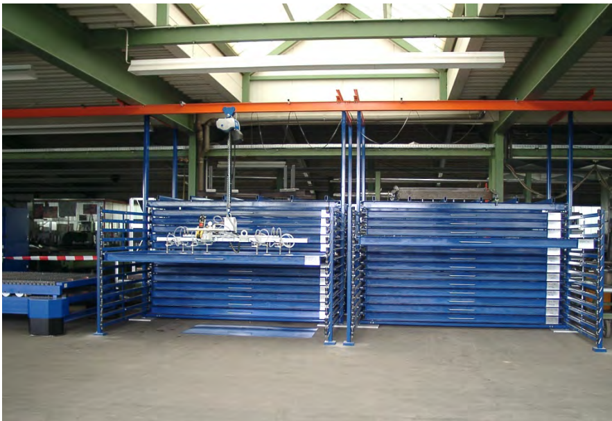
Doppelanlage zur Beladung mit einem festen Hallenkran.
